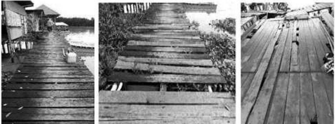
Gambar 2. Kondisi Kerusakan Sarana Pelabuhan Trestle dan Geladak Moda Waterway
