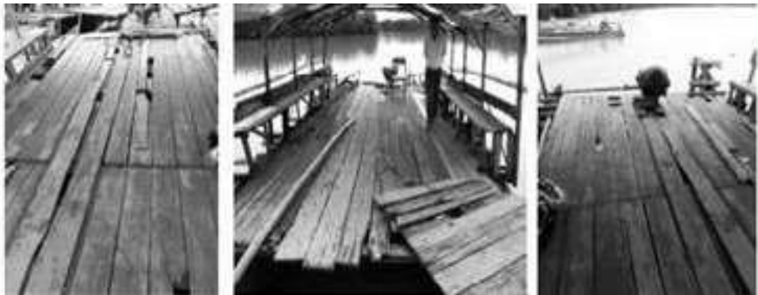
Gambar 3. Kondisi Ketiga Geladak Moda Waterway yang Rusak
