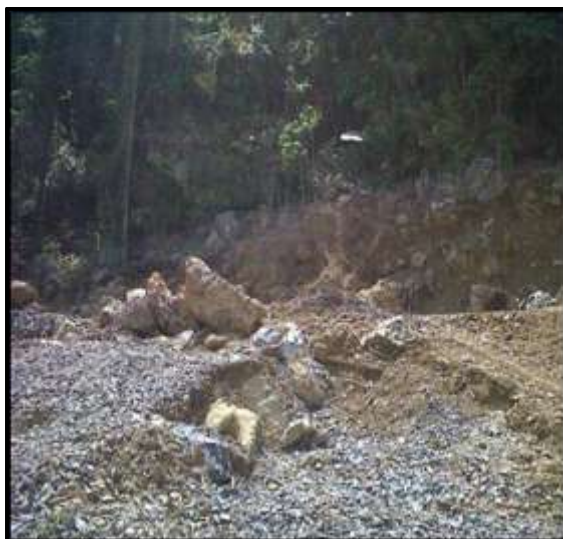
Gambar 7. Batugamping yang retak dan mudah lepas sebagai salah satu penyebab terjadinya tanah longsor di lokasi kedua (ST-02).
